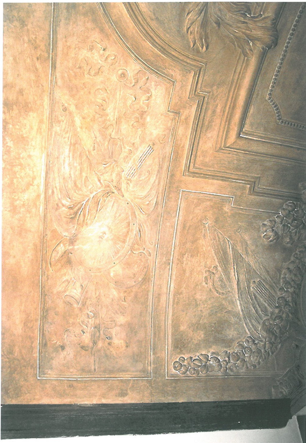
Fot. nr 10. Ściana wschodnia, detal - płycina z panopliami. Widoczne rozległe zaplamienia, spowodowane niejednorodną chłonnością podłoża przesyconego nawarstwieniami smolistymi z dymu papierosowego i winacetem pochodzącym z poprzednich prac konserwatorskich oraz pociemniałe ugrowe przemalówki i punktowania. Gzyms jest przemalowany farba olejną na czarno.
