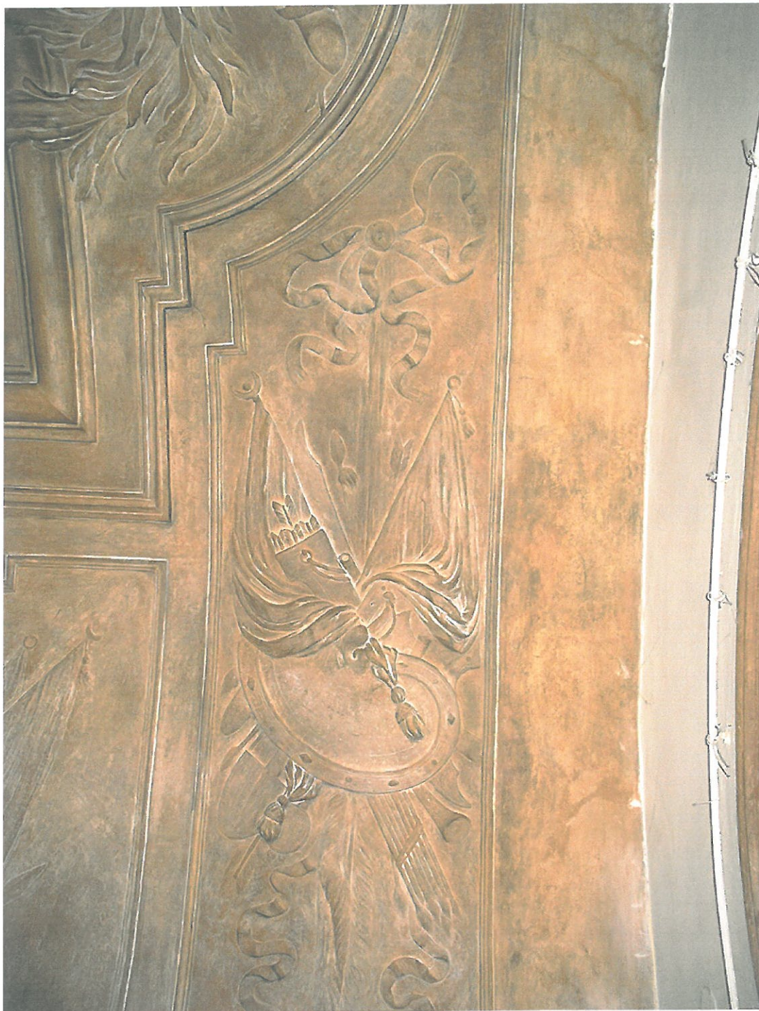
Fot. nr 9. Ściana zachodnia, detal - płycina z panopliami. Widoczne rozległe zaplamienia, spowodowane niejednorodną chłonnością podłoża przesyconego nawarstwieniami smolistymi z dymu papierosowego i winacetem pochodzącym z poprzednich prac konserwatorskich oraz pociemniałe ugrowe przemalówki i punktowania. Gzyms jest przemalowany farba olejną na czarno.
