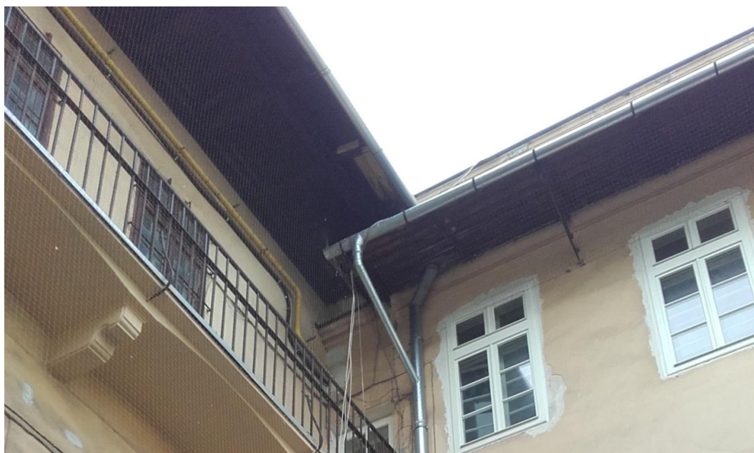
Elewacja oficyny. Widoczne zadaszanie na elewacji Zach wykonane po roku 1973, zabrudzenia tynku.
