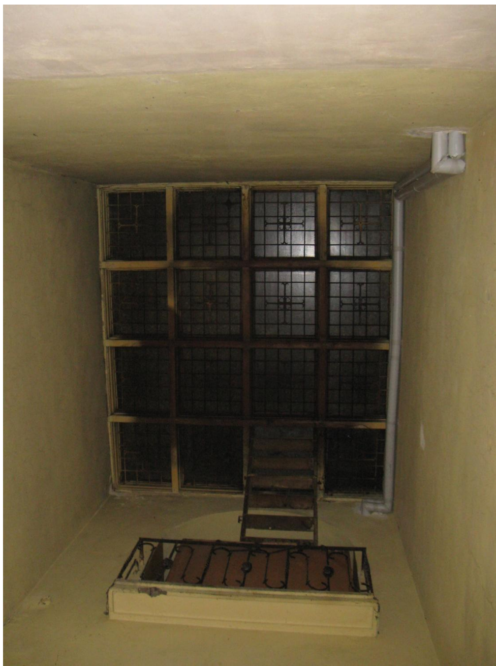
Klatka schodowa – widoczne zacieki na naświetlu, nieestetyczne rury instalacyjne.
