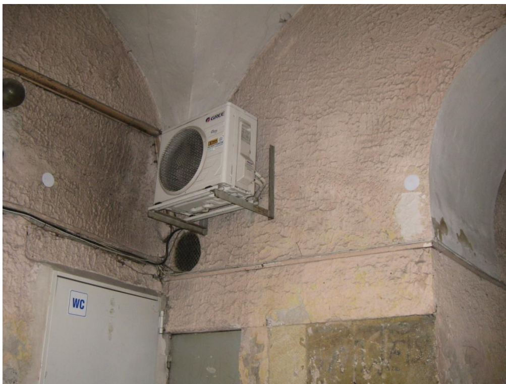
Sień – widoczny stan zachowania tynku, przekucia i przemurowania.
