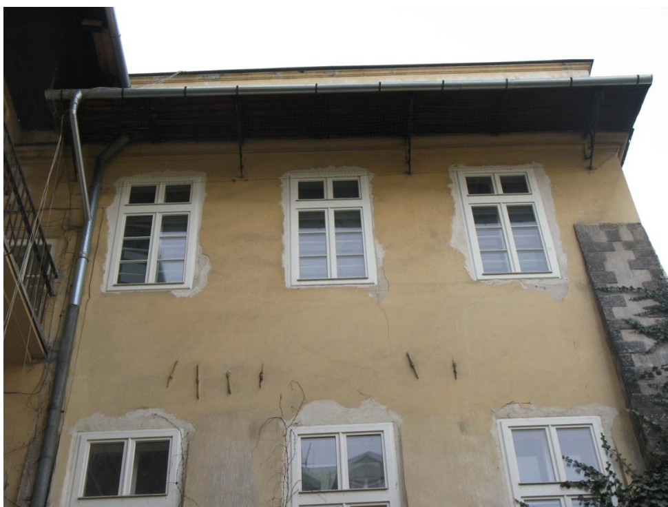
Elewacja oficyny – „nowe” zadaszanie. Widoczne zabezpieczenie siatką przed ptactwem i nowa stolarka okienna. Wokół niej spękania i przemurowania tynku.
