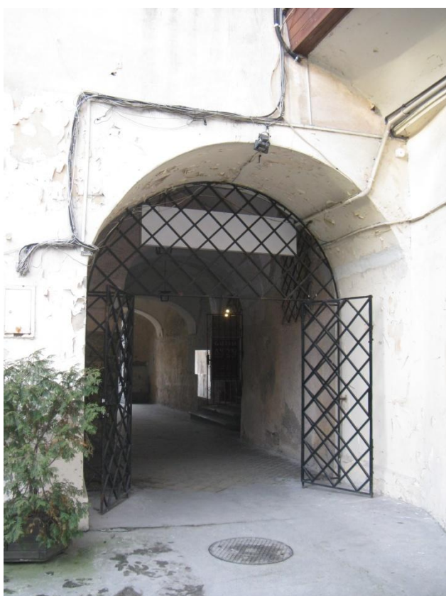
Elewacja tylna budynku głównego – widoczny stan zachowania powłok malarskich oraz tynku, kable biegnące po elewacji.
