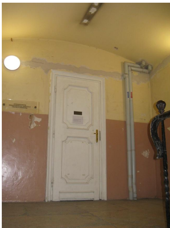
Klatka schodowa - Widoczne drzwi do konserwacji oraz nieestetyczne rury instalacyjne.
