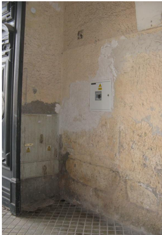
Sień – ściana Pd. Widoczny stan zachowania tynku, skrzynki instalacji elektrycznych.
