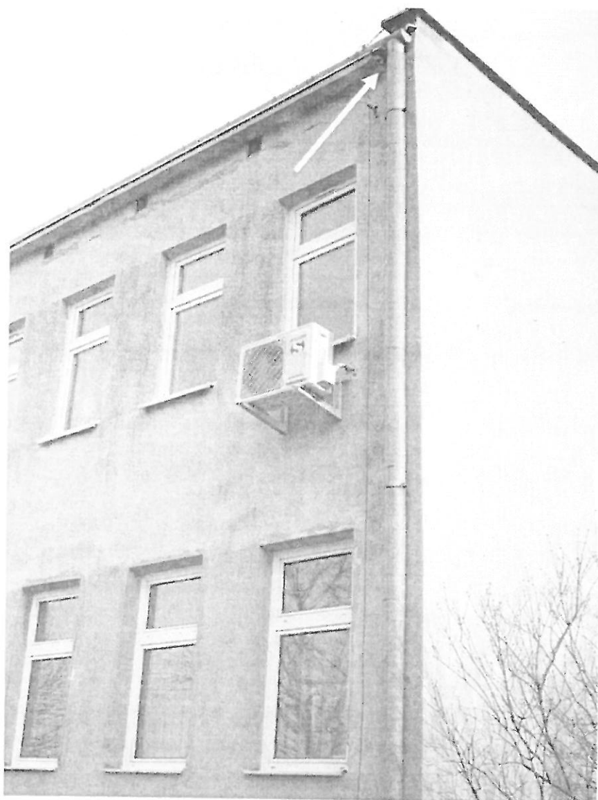
Fot. 5. Kraków, Heleny 2 – ściana zachodnia i południowa budynku. Wskazano szczeliny, które należy zamknąć do końca lutego przed okresem remontu.
