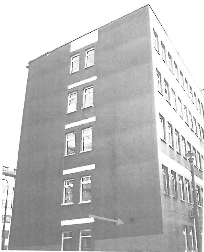
Fot. 10. Kraków, Rusznikarska 17 – ściana północna I segmentu. Wskazano dwa okienka wentylacyjne w których przesiadują gołębie miejskie. . Konieczne zamknięcie do końca lutego, by uniemożliwić zagnieżdżenie się ptaków.
