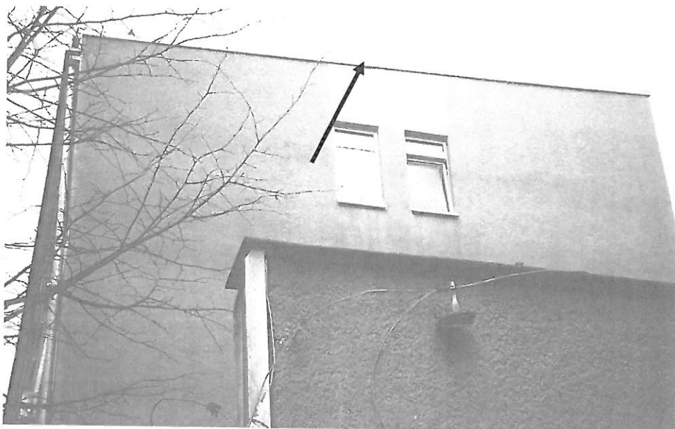
Fot. 11. Kraków, Rusznikarska 17 – ściana południowa II segmentu budynku. W miejscu wskazanym strzałką znajdują się ubytki tyku, potencjalne miejsca wejścia ptaków pod oblachowanie krawędzi dachu. Konieczne zamknięcie do końca lutego, by uniemożliwić zagnieżdżenie się ptaków.
