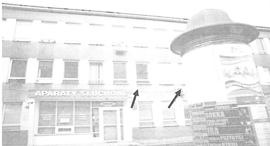
Fot. 6. Kraków, Al. Pokoju 4 – ściana południowo-wschodnia budynku, część zachodnia. Wskazano strzałkami dwa miejsca w których pod blaszanym parapetem znajdują się szczeliny, potencjalne siedlisko jerzyka.
