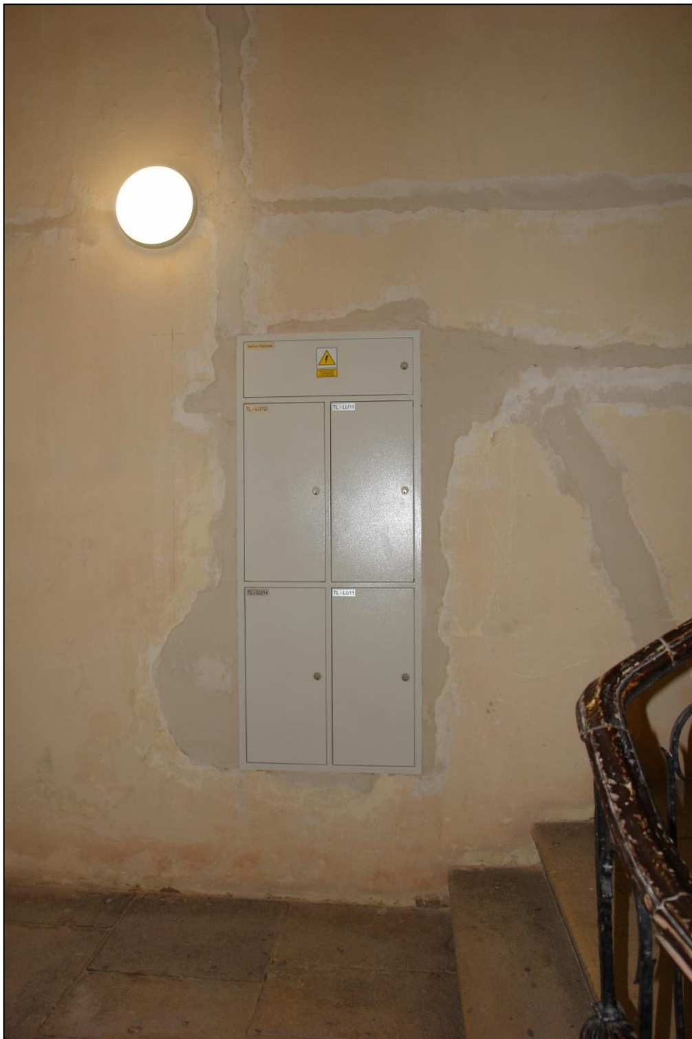
Klatka schodowa – widoczne przekucia i przemurowania tynków.
