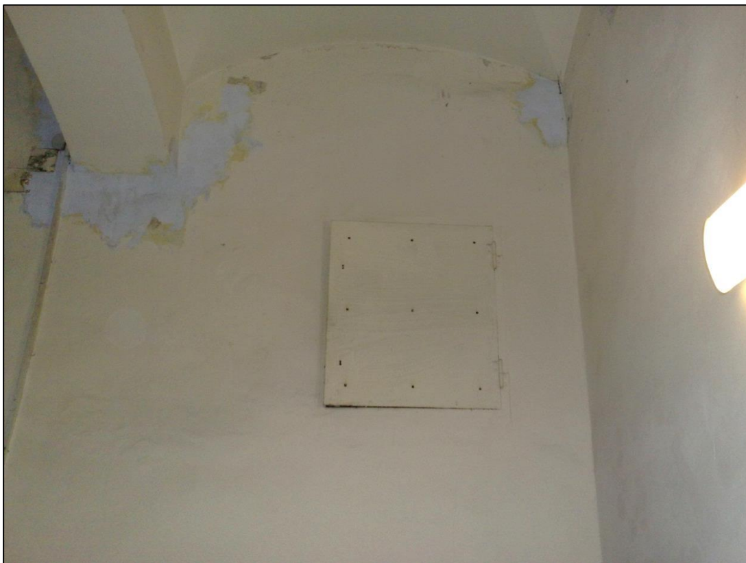
Klatka schodowa – widoczne przemurowania tynku.
