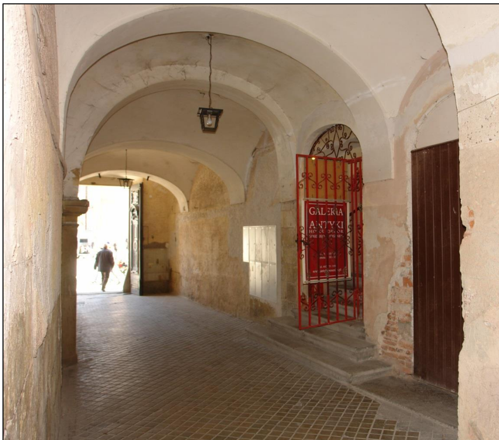
Sień przejazdowa. Widoczny zły stan techniczny powłok malarskich oraz tynków, uzupełnienia posadzki oraz wtórną kolorystykę metaloplastyki..
