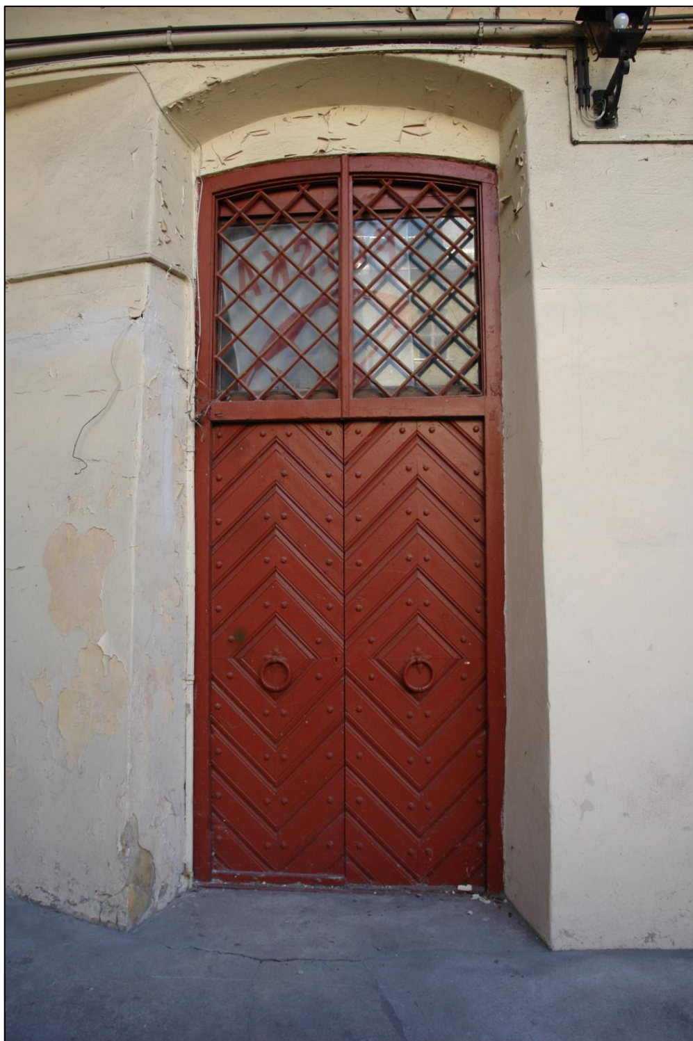
Oficyna boczna – Drzwi drewniane z naświetlem. Widoczna nowa kolorystyka drzwi oraz metaloplastyki w jednolitym kolorze brązowym oraz uszkodzenia powłok malarskich na tynku pochodzących z różnych okresów doraźnych reperacji.
