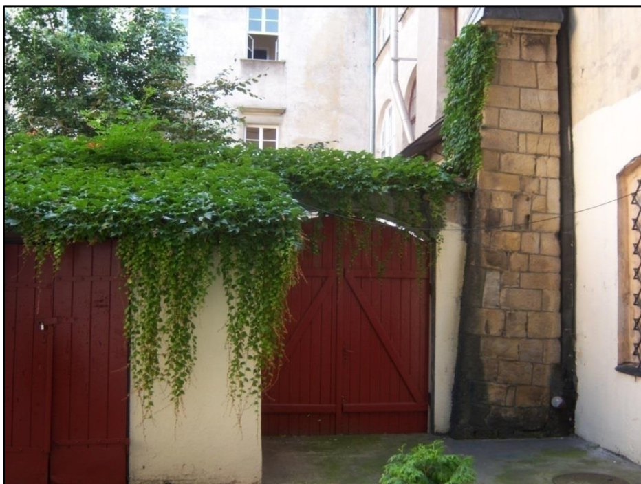
Widoczna brama w murze granicznym posesji, z prawej strony pozostałość kamiennego muru. Kamieniarka z piaskowca silnie uszkodzona i zabrudzona.
