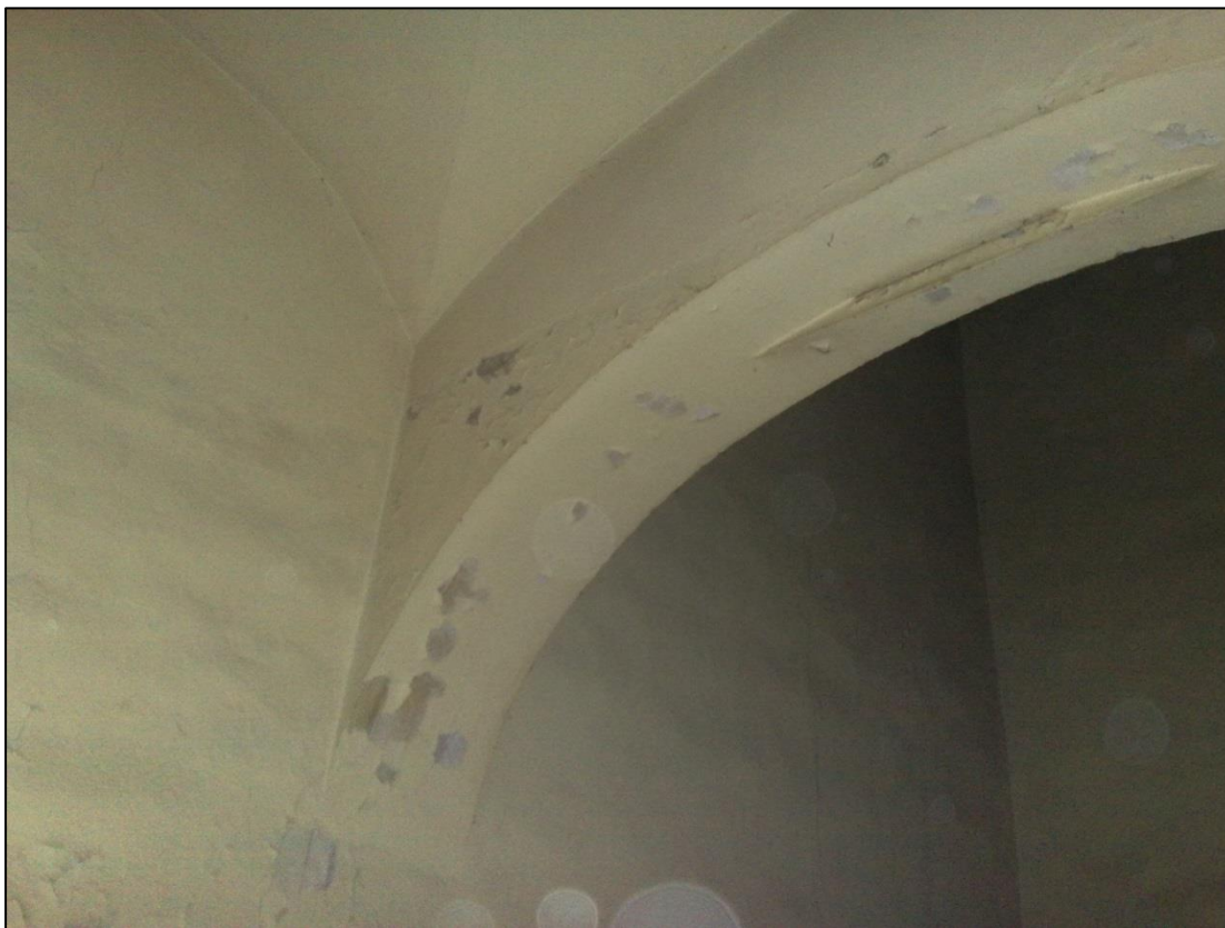
Klatka schodowa – widoczne uszkodzenia powłoki malarskiej.
