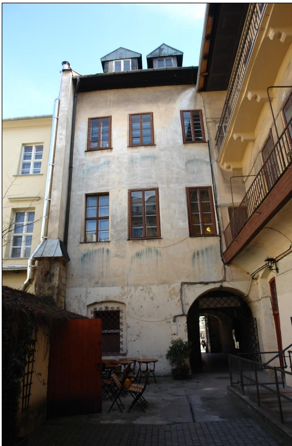
Elewacja tylna budynku głównego – widoczny stan zachowania powłok malarskich z różnych stanów renowacji oraz tynku, przebarwienia od parapetów miedzianych.
