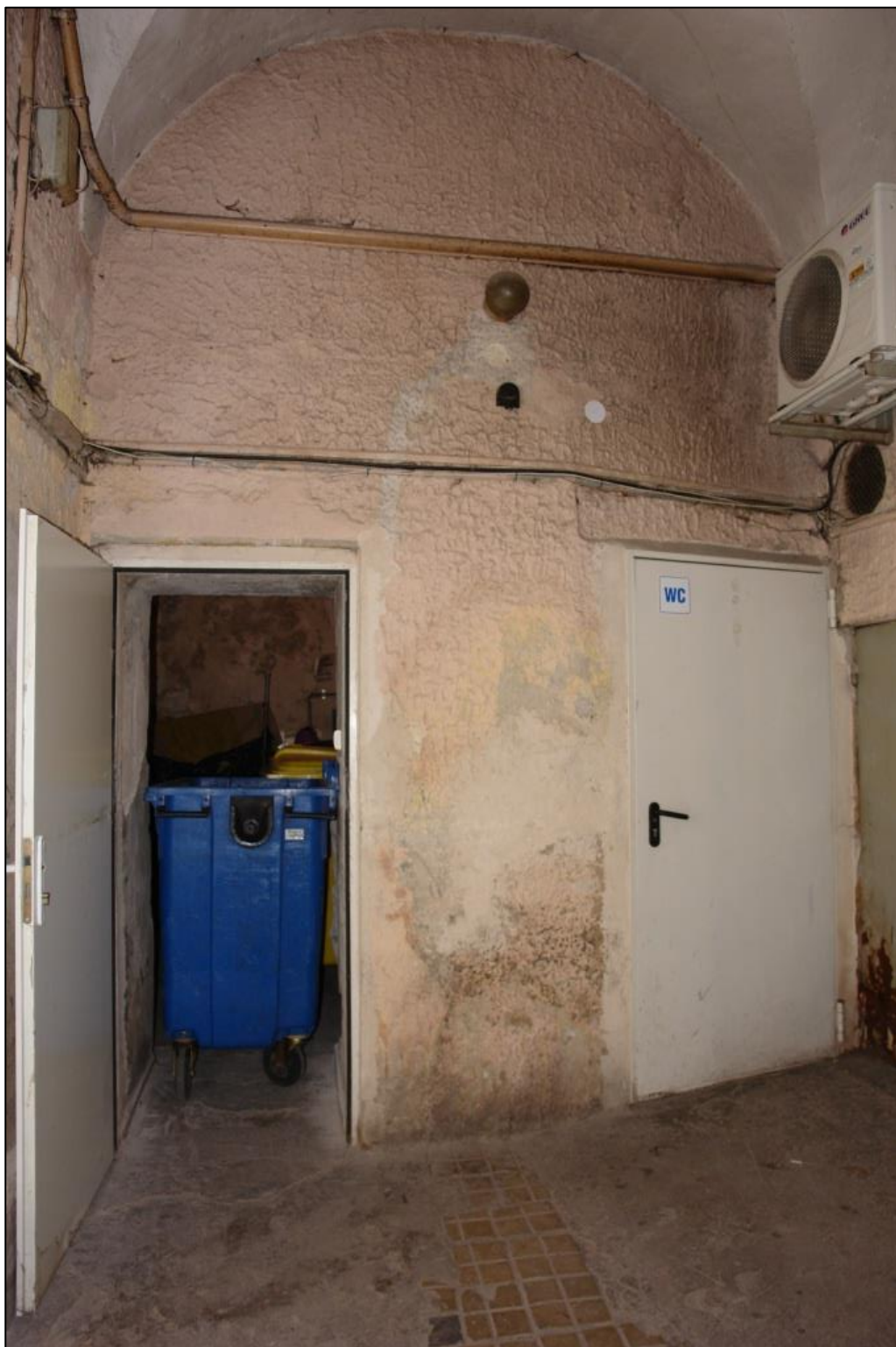
Sień – widoczny stan zachowania tynku, przekucia i przemurowania.
