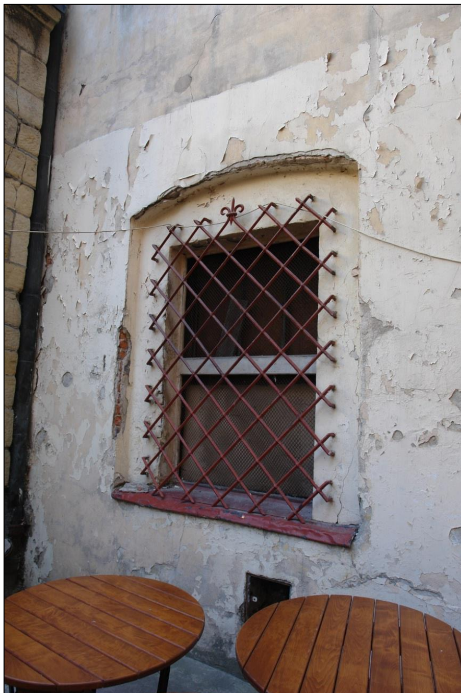
Elewacja Zach budynku głównego – okno na parterze. Widoczna stalowa kratka, uszkodzenia powłok malarskich oraz tynku.
