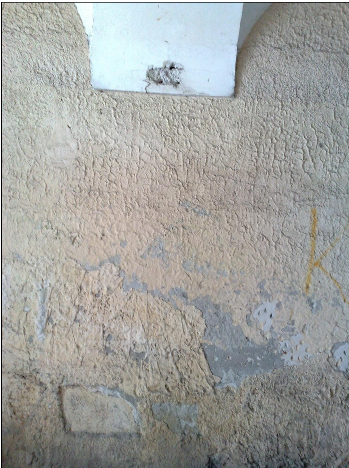
Sień - widoczny stan zachowania tynku, reperacje.
