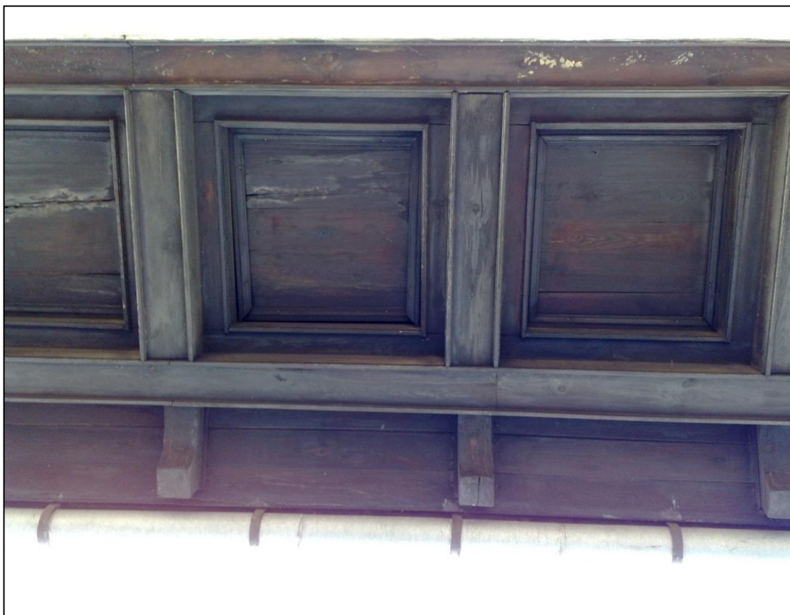
Oficyna boczna – widoczne deskowanie okapu - uszkodzenia drewna.
