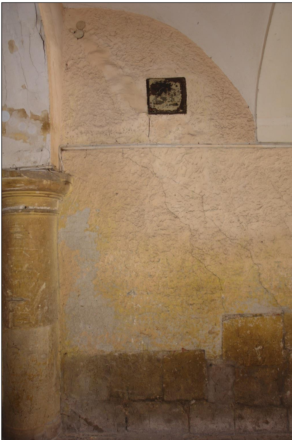
Sień przejazdowa – ściana PN. Widoczne uszkodzenia powłoki malarskiej, ukośne pęknięcia tynku, stan zachowania kamieniarki.
