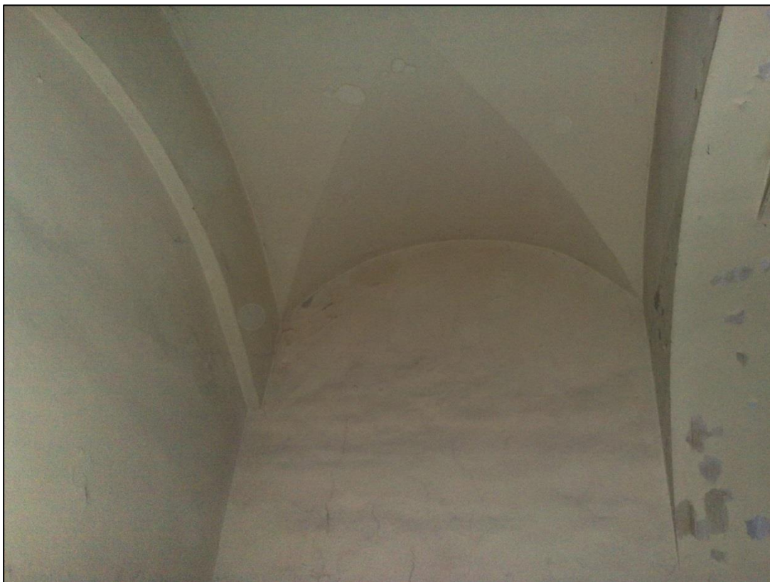
Klatka schodowa. Widoczny stan zach. tynków i powłoki malarskiej.
