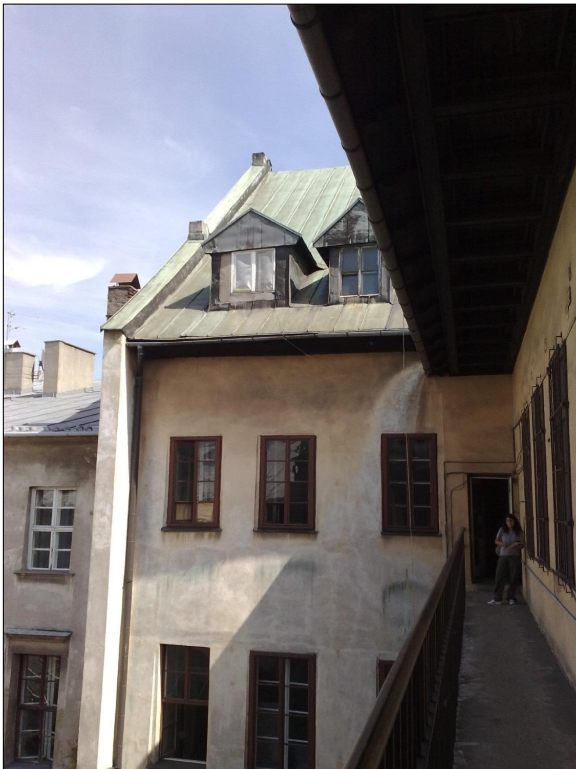
Elewacja tylna budynku głównego. Widoczny stan zach. blacharki dachu, zabrudzenia i uszkodzenia powłoki malarskiej tynku.
