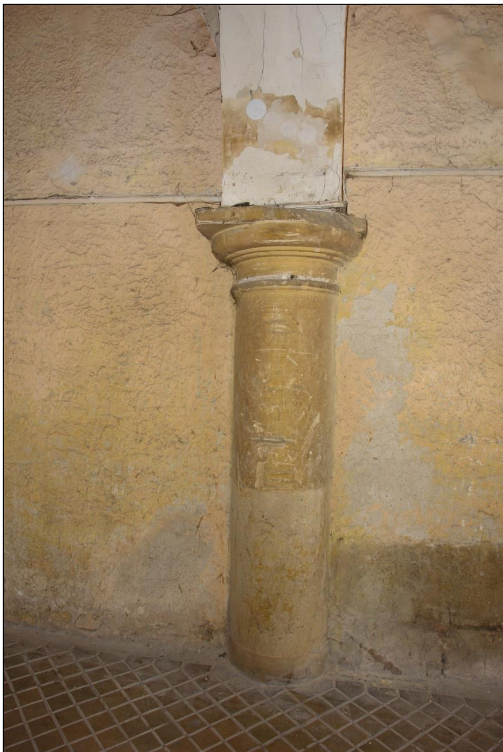
Sień – kolumna dorycka wykonana z wapienia. Widoczne uszkodzenia kamieniarki, na ścianie tynk fakturowy zasolony z uszkodzeniami.
