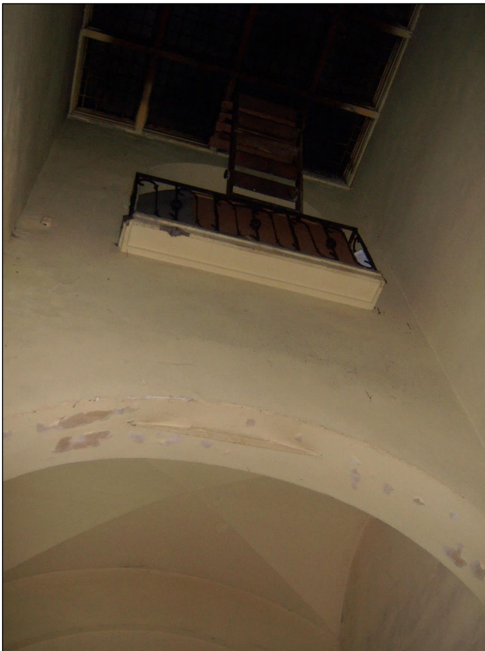
Klatka schodowa – widoczne uszkodzenia powłoki malarskiej.
