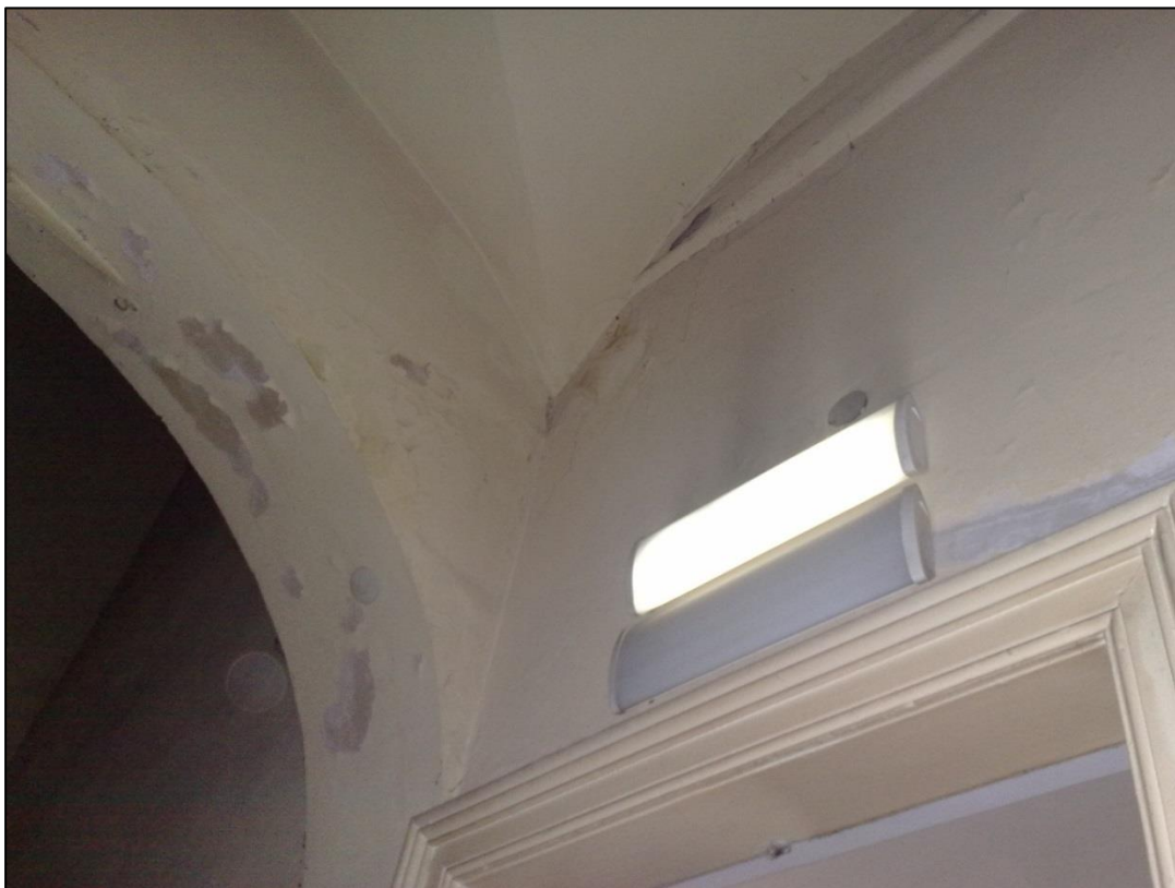
Klatka schodowa – widoczne uszkodzenia powłoki malarskiej.
