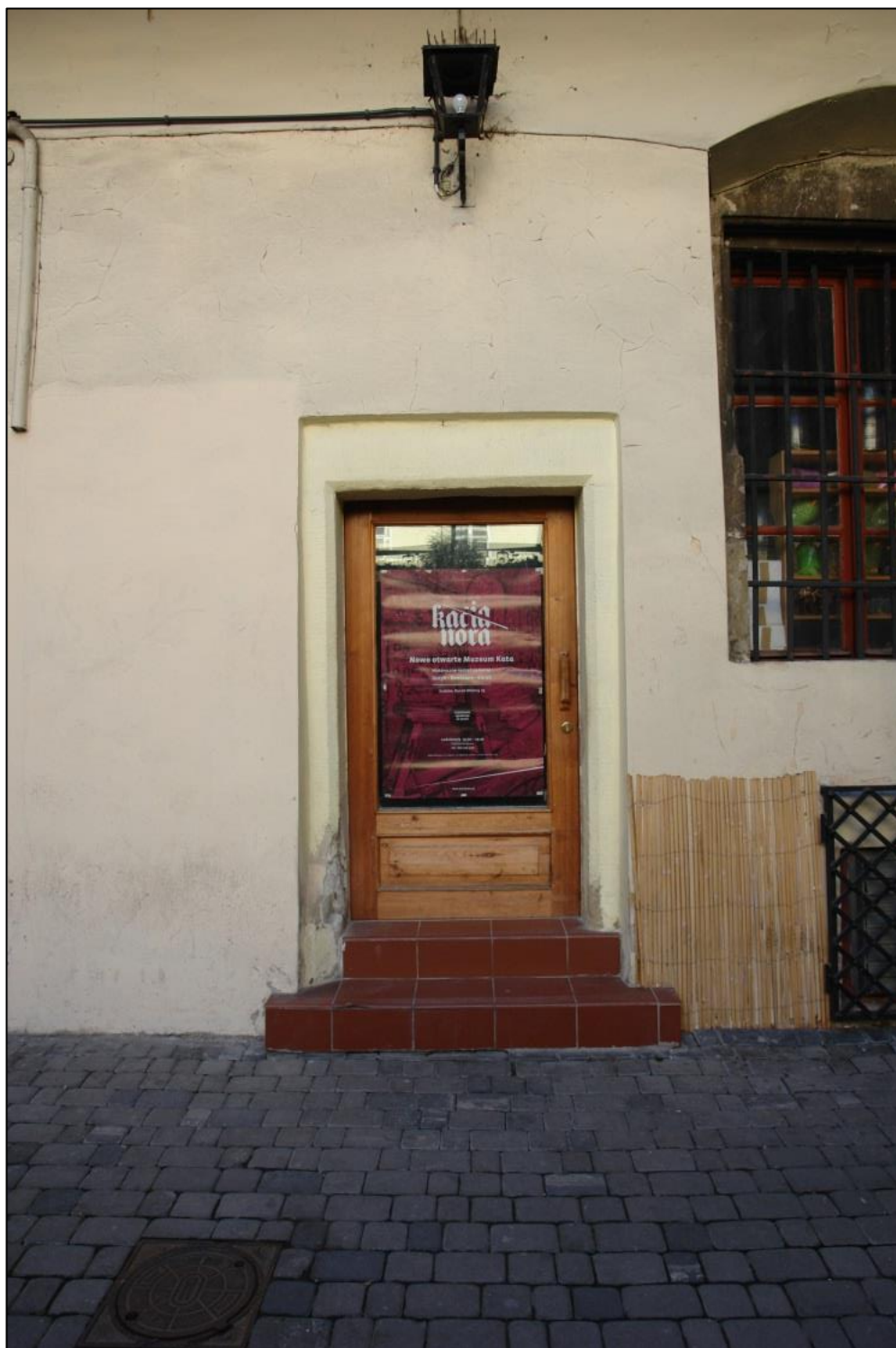
Elewacja oficyny bocznej – parter – Widoczny kamienny portal wtórnie przemalowany, nowe drzwi drewniane lakierowane, przeszklone.
