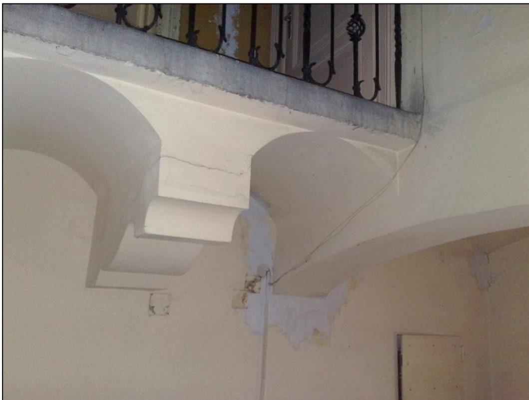
Klatka schodowa – widoczne przemulowania tynku, zarysowanie konsoli.
