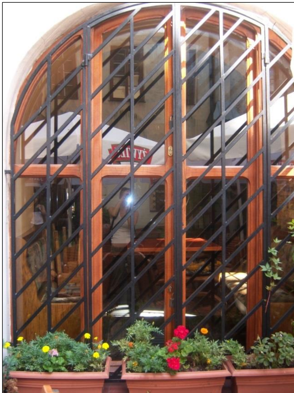
Elewacja oficyny tylnej – okno parteru. Widoczna nowa stolarka okienna, nowa krata stalowa.
