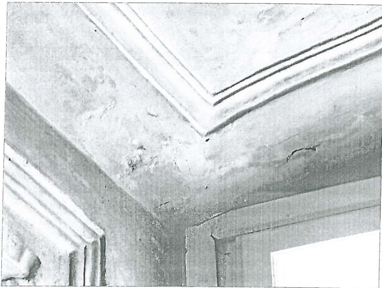
Stan tynków nad oknami od ul. Szczepańskiej
