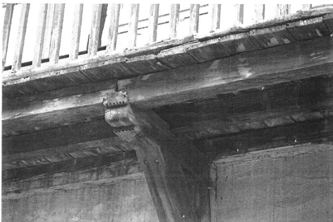
Fot.4. Budynek mieszkalny, ul. B. Limanowskiego 32, Kraków. Elewacja tylna. Fragment galerii drewnianej. Widoczny wspornik oraz stan desek tworzących galerię.
