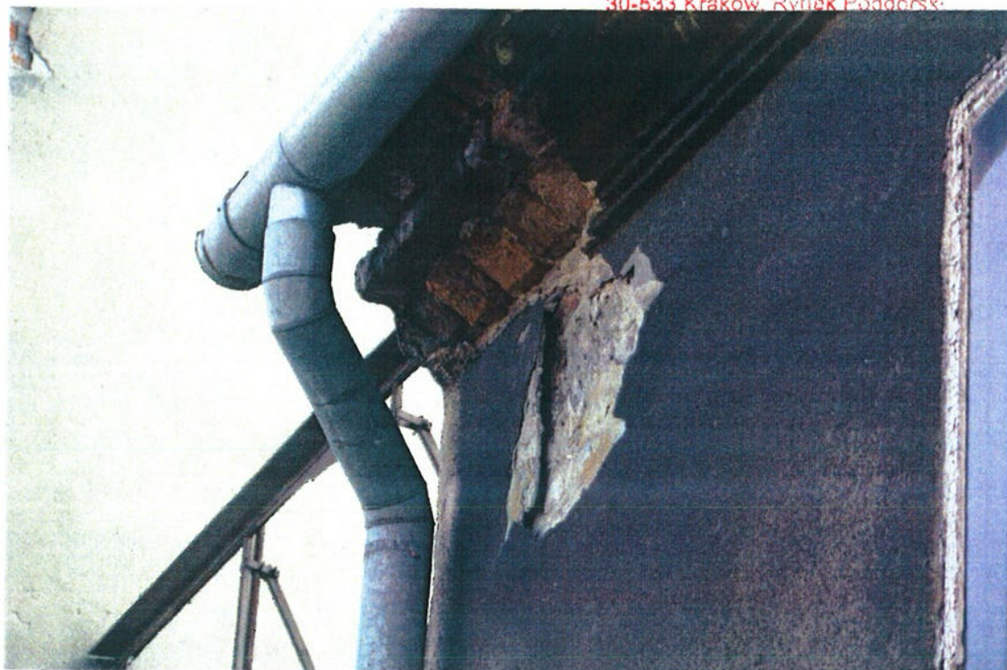
Fot.5. Budynek mieszkalny, ul. B. Limanowskiego 30, Kraków. Elewacja frontowa. Fragment. Widoczne zniszczenia gzymsu i części ściany.
