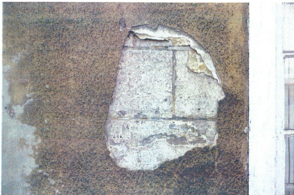
Fot.3. Budynek mieszkalny, ul. B. Limanowskiego 30, Kraków. Elewacja frontowa. Fragment. Widoczne zniszczenia warstw tynku i pozostałości boniowania pod nimi. Fot. Anna Frandlucha
