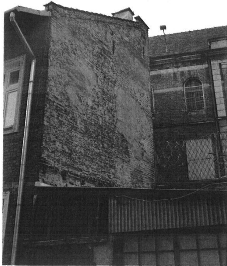
Fot.5. Oficyna tylna budynku przy ul. B. Limanowskiego 32. Elewacja zachodnia. Widoczny stan ściany- resztki warstw tynku, oraz zniszczone cegły.
