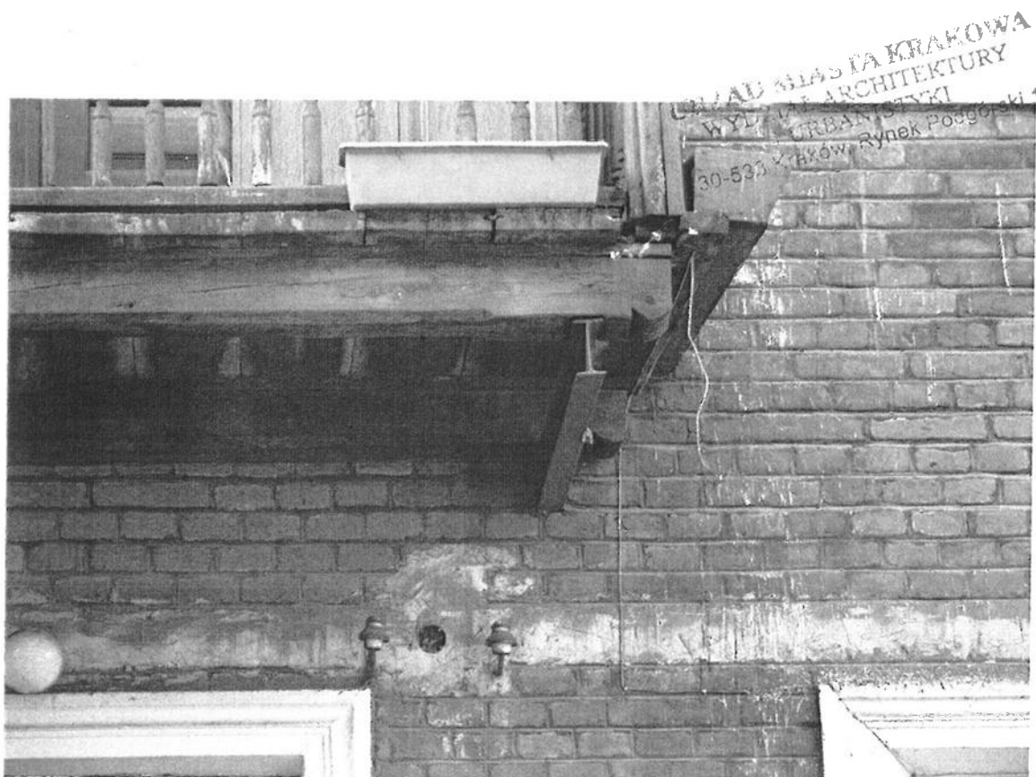
Fot.3. Oficyna tylna budynku przy ul. B. Limanowskiego 32. Elewacja frontowa. Fragment. Widoczna metalowa belka stanowiąca wspornik dla galerii drewnianej, a także ślady po poprzednich działaniach remontowych, oraz stan cegły.
