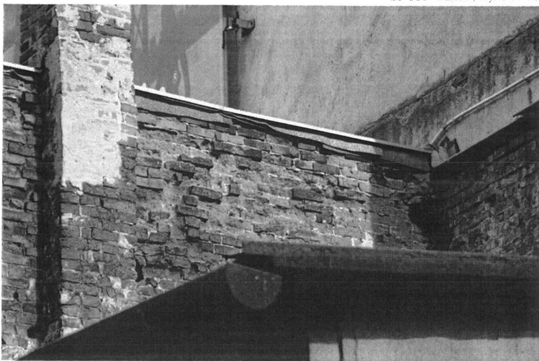
Fot.4. Budynek użytkowy, ul. B. Limanowskiego 34, Kraków. Elewacja tylna. Fragment. Widoczny stan cegieł z których zbudowana jest pokazana ściana. Fot. Anna Frandlucha
