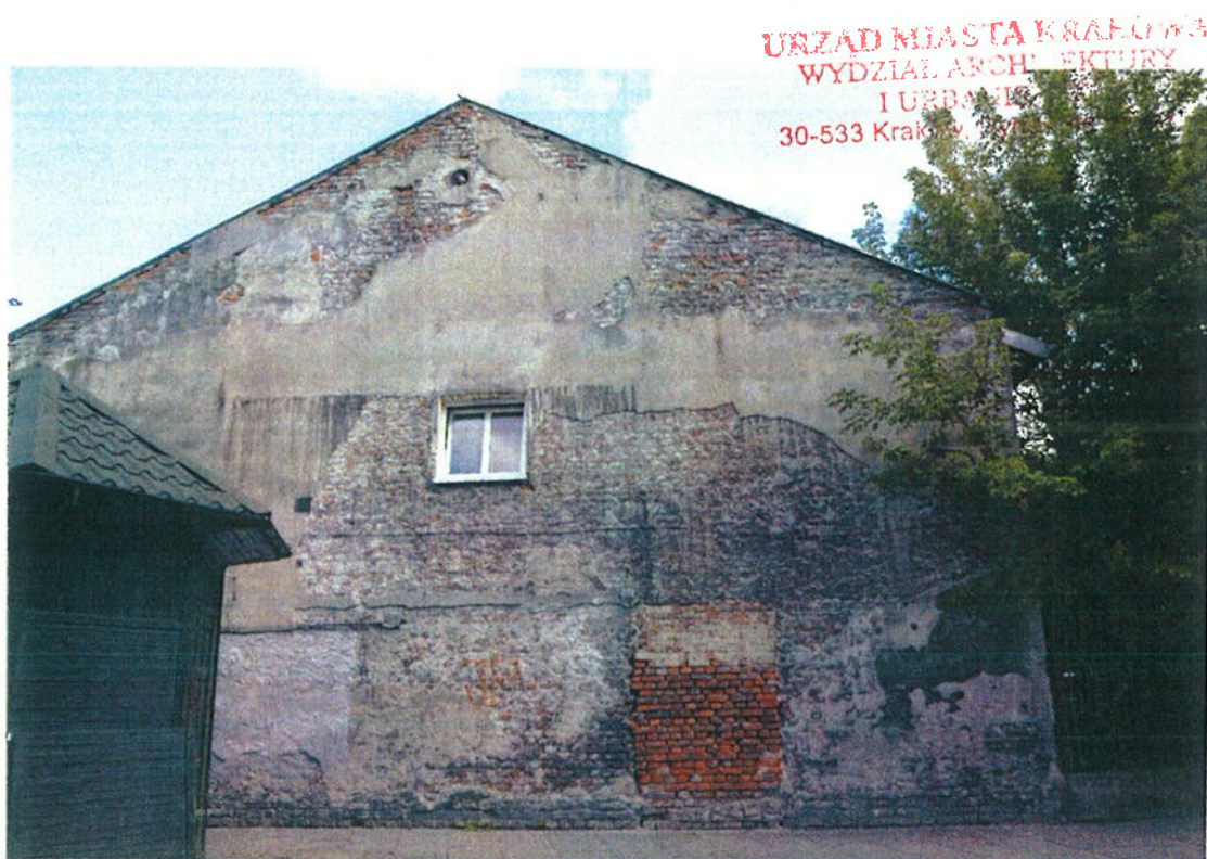
Fot.4. Budynek mieszkalny, ul. B. Limanowskiego 30, Kraków. Elewacja zachodnia. Widok ogólny. Widoczne rozległe zniszczenia i miejscowe przemurowania. Fot. Anna Frandlucha
