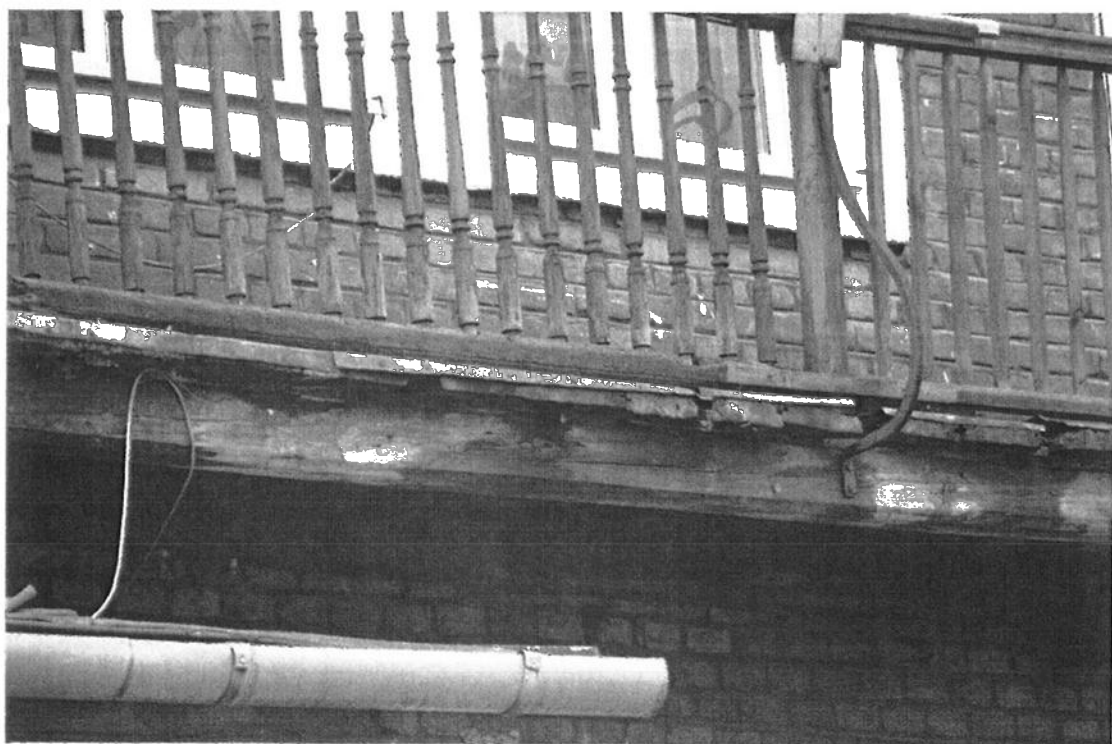
Fot.2. Oficyna tylna budynku przy ul. B. Limanowskiego 32. Elewacja frontowa. Fragment galerii drewnianej. Widoczny stan desek z których jest zbudowana.
