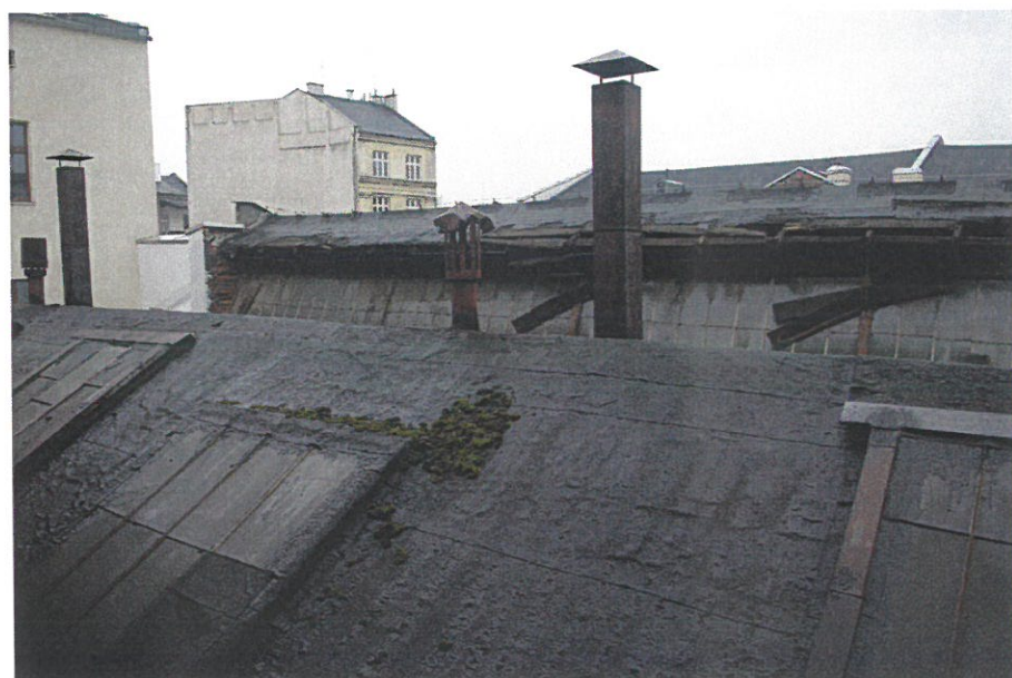
Fot. 4 Dach oficyny widziany z klatki schodowej kamienicy przy ul. św. Wawrzyńca 26, widoczne liczne uszkodzenia pokrycia z papy, okien dachowych oraz systemu odwodnienia.
