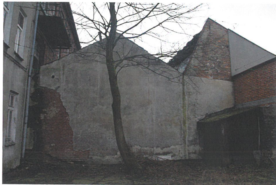
Fot. 1 Widok od strony wschodniej, z podwórka posesji przy ul. św. Wawrzyńca 26, widoczne liczne ubytki w tynku i uszkodzenia muru ceglanego.
