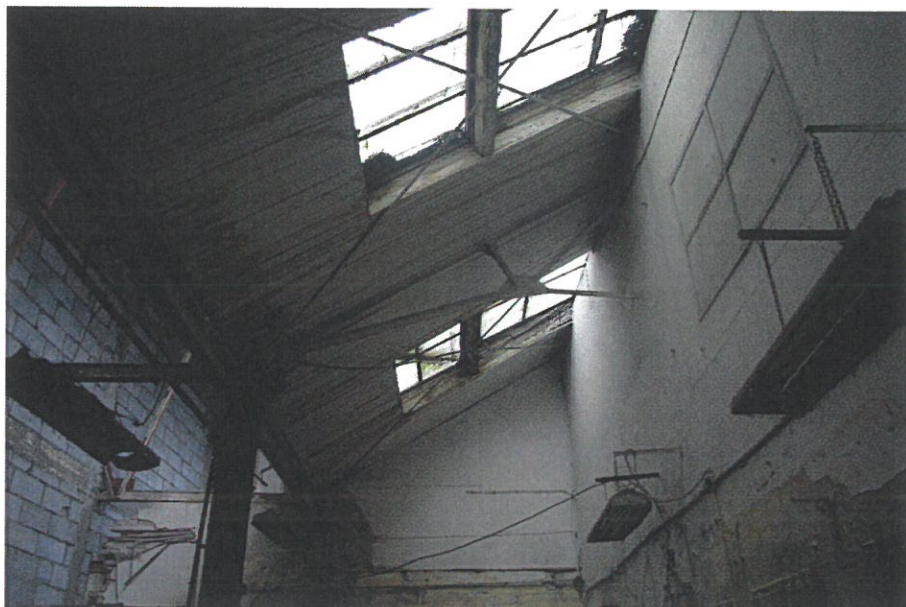
Fot. 11 Konstrukcja dachu w głównym pomieszczeniu oficyny, widoczne liczne zacieki świadczące o nieszczelnościach pokrycia.
