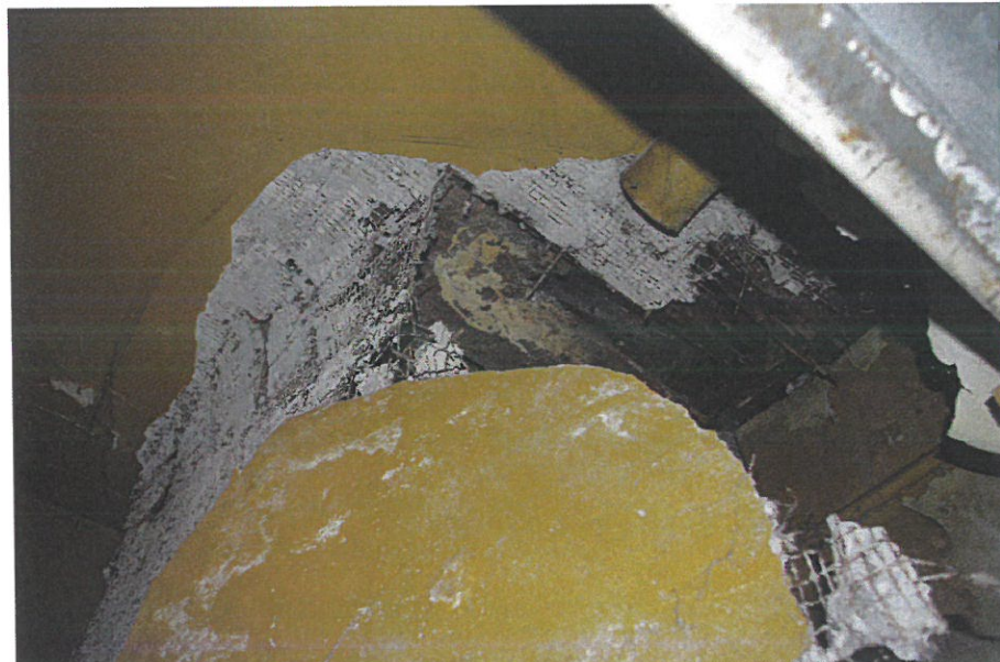
Fot. 8 Uszkodzenia stropu nad kondygnacją parteru.
