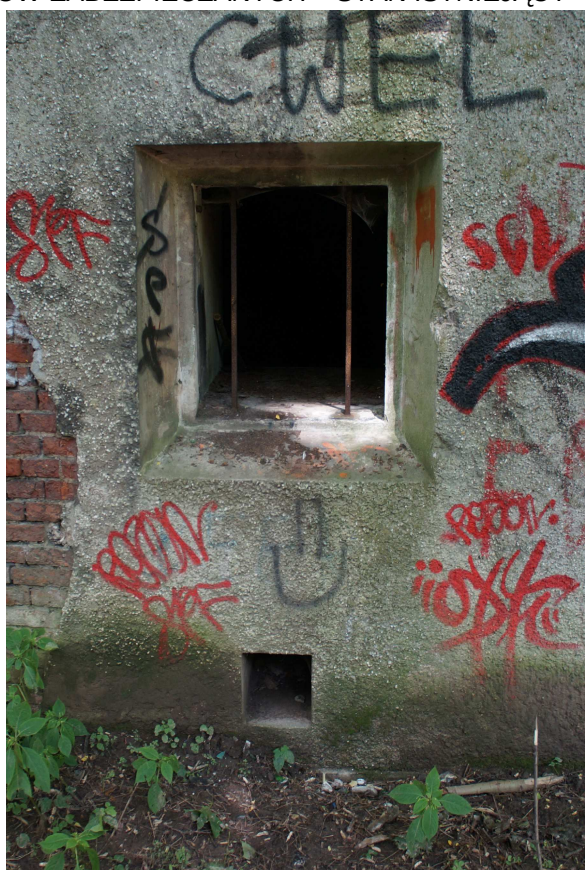
SCHRON GŁÓWNY – OTWÓR z brakującą kratą
