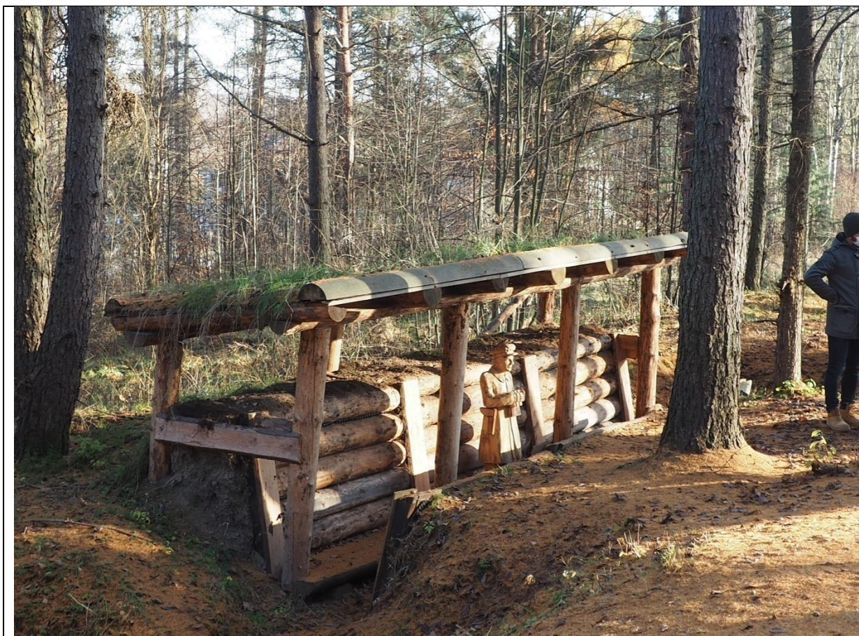
Ryc. 24. Punktowa rekonstrukcja dachów przeciwszrapnelowych ("deckungów") i szalowania okopu w miejscu potwierdzonym badaniami archeologicznymi
