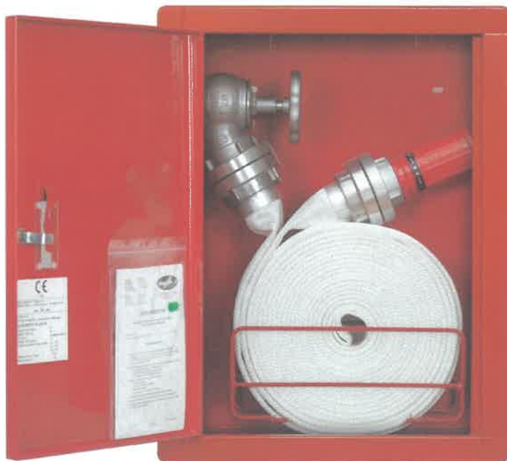
Hydrant wewnętrzny 52 z wężem półsztywnym
