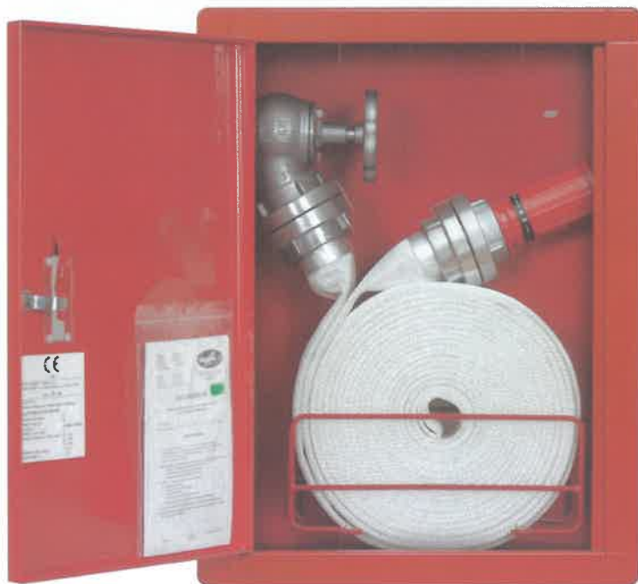
Hydrant wewnętrzny 52 z wężem półsztywnym
